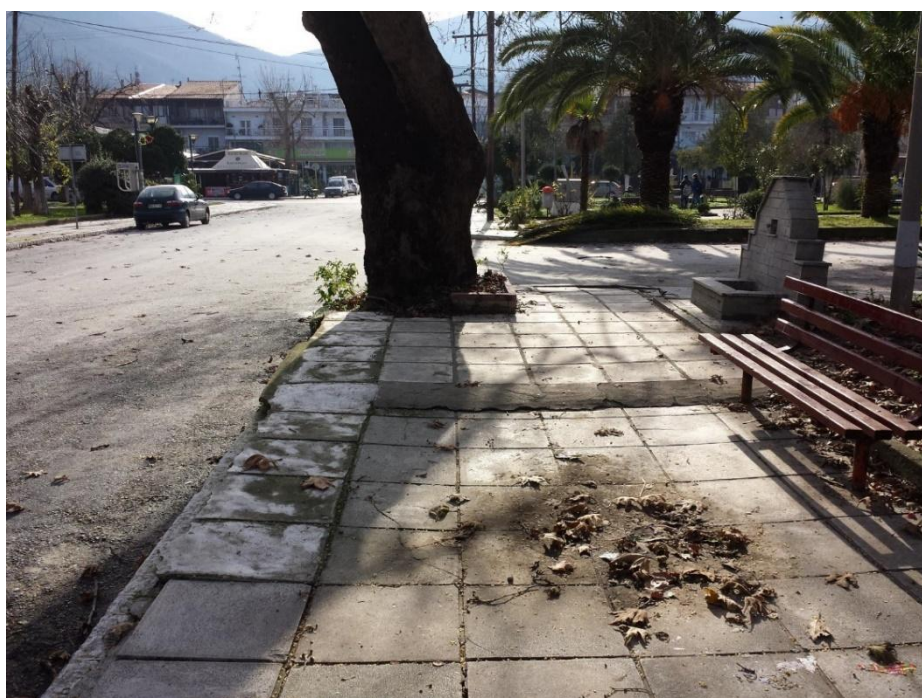
Φωτ.4. Φθαρμένες πλάκες πεζοδρομίου- Λήψη προς Οικισμό
